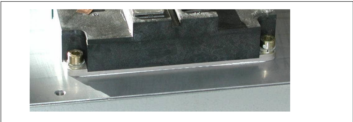
图. 9: 模块边缘渗漏出过量的导热膏
